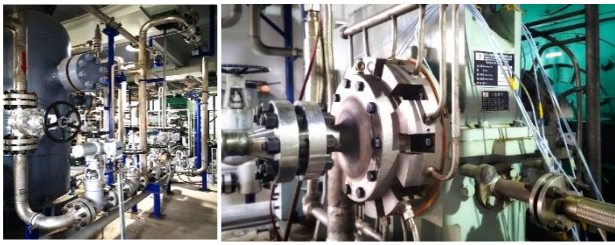
MW级压缩机实验系统和工程样机
